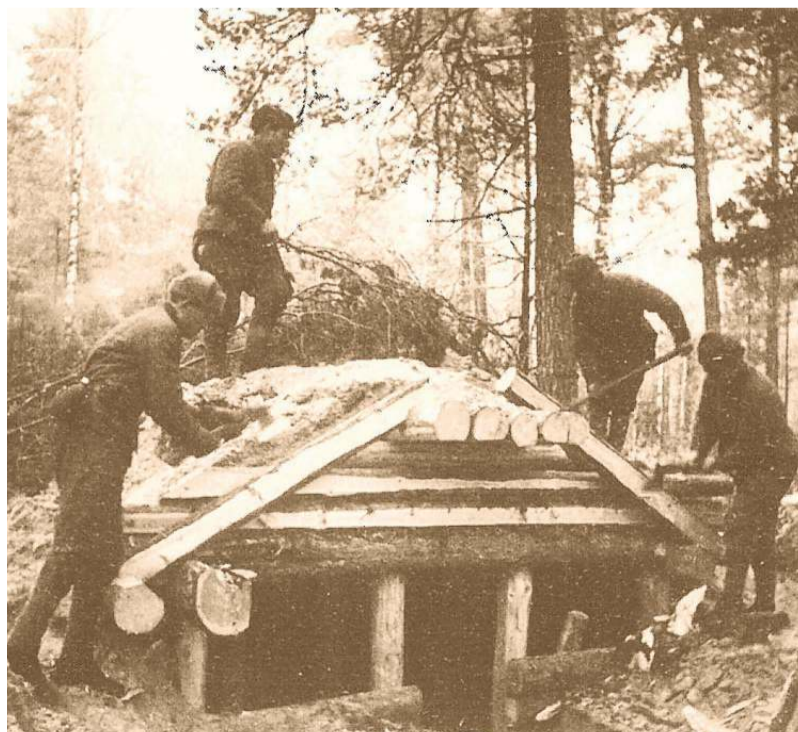
Seltene Quelle: Das Foto zeigt Pioniere der 193. Dnjepr-Schützendivision beim Bau eines einfachen Unterstandes, aufgenommen Ende 1943. Das Bild stammt aus „Iwans Krieg“ von Catherine Merridale.
